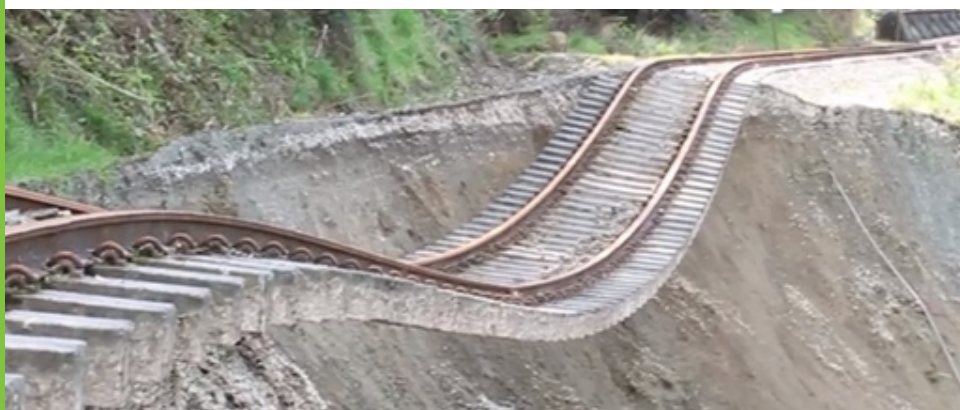
Raupunga washout on Napier/Wairoa line
