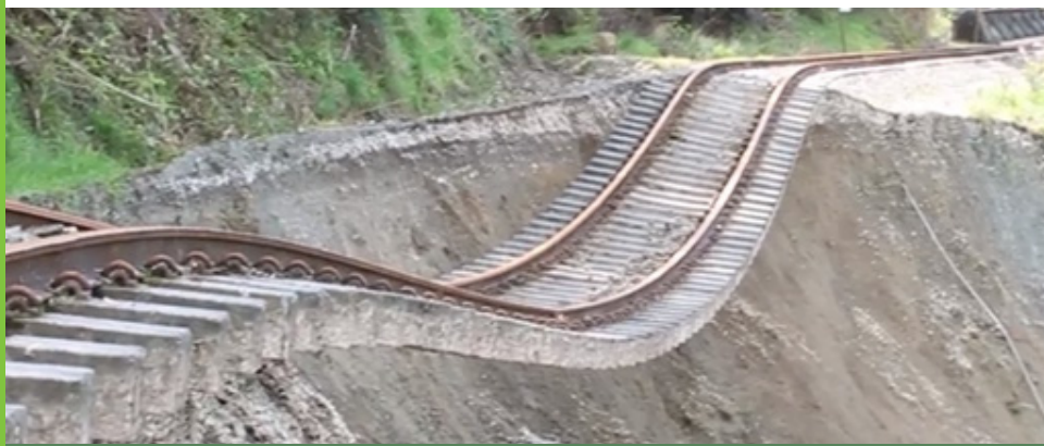
Raupunga washout on Napier/Wairoa line
