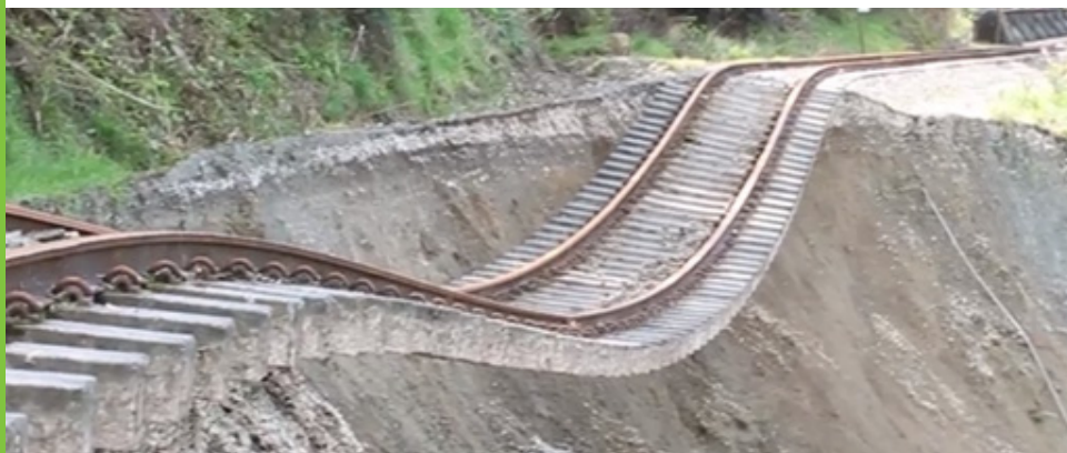
Raupunga washout on Napier/Wairoa line
