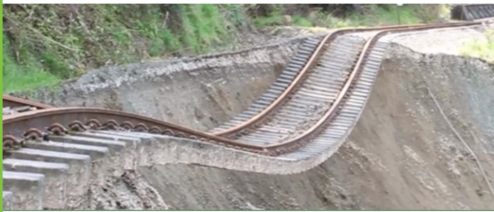
Raupunga washout on Napier/Wairoa line
