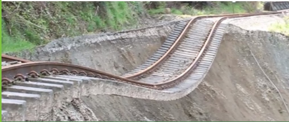
Raupunga washout on Napier/Wairoa line
