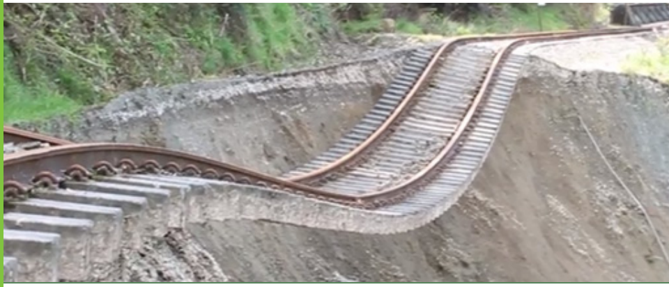
Raupunga washout on Napier/Wairoa line
