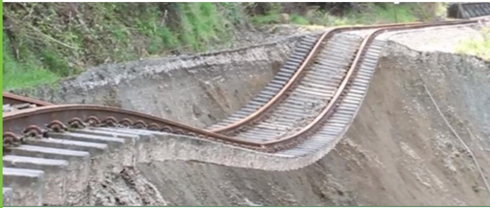
Raupunga washout on Napier/Wairoa line
